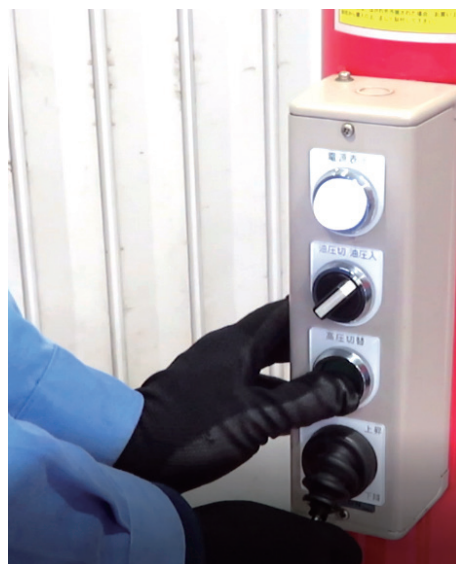
高圧切替時プレス操作
