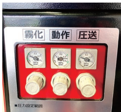
クリーム圧力レギュレーター
